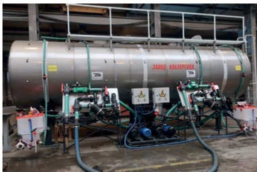
Стационарный растворный узел РЗС-20 с двумя независимыми отсеками
